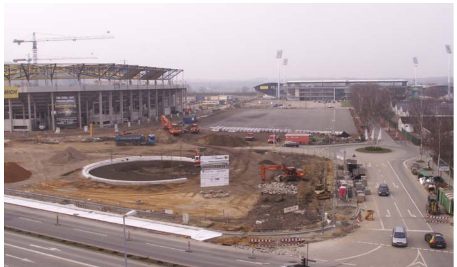
Hier entsteht das neue "Eingangstor" zum Sportpark Soers von Alemannia Aachen (links) und CHIO Aachen an der Krefelder Straße. Fotos: ALRV
